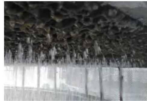
未安装的冷却塔有明显绿藻
