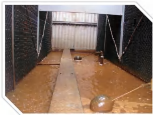
安装前，水质浑浊
