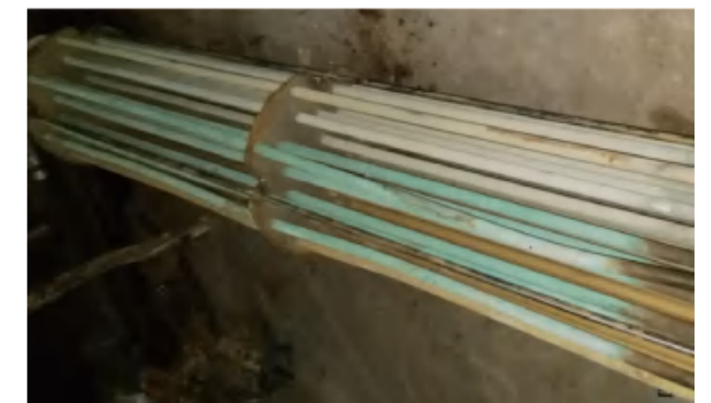
新换的安装海卓帕斯电子水处理器，没有腐蚀
